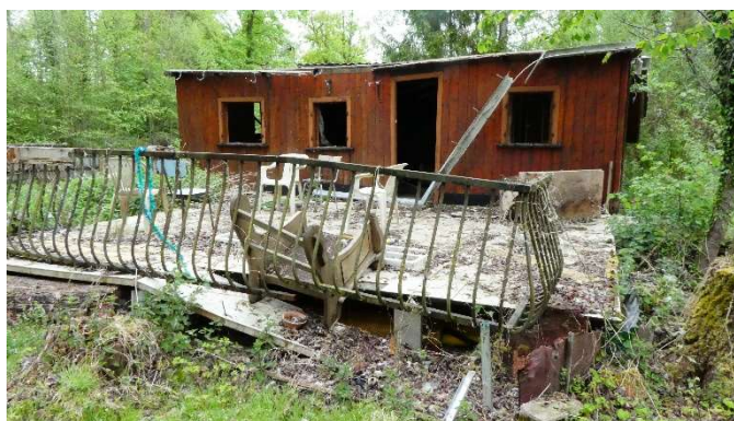
Photo 2 : Cabanon abandonné présent sur le marais de Fontenay (In situ © IEA)
